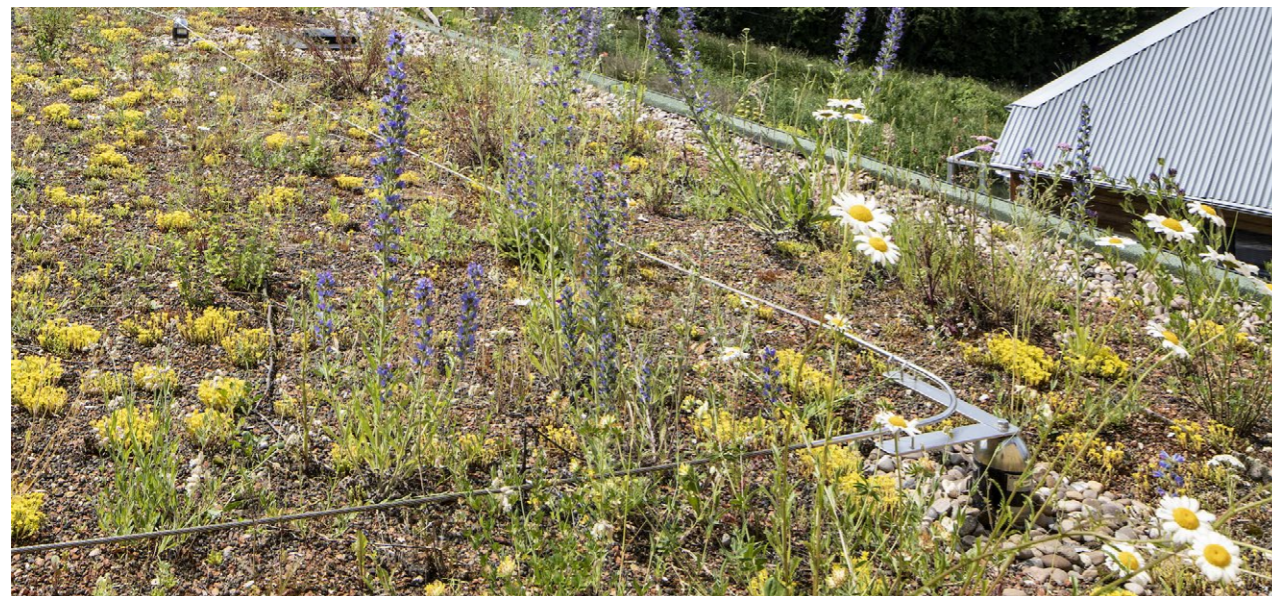
Image: Biodiverse green roof.
